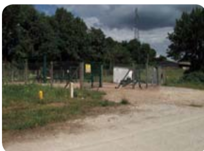
La station de détente de gaz de la Maison Rouge
