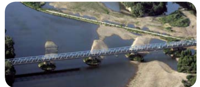
Le pont de Fourchambault est vulnérable dès la crue centennale, le tablier est menacé. Les aménagements proposés apportent globalement une réduction de la vulnérabilité des réseaux.
