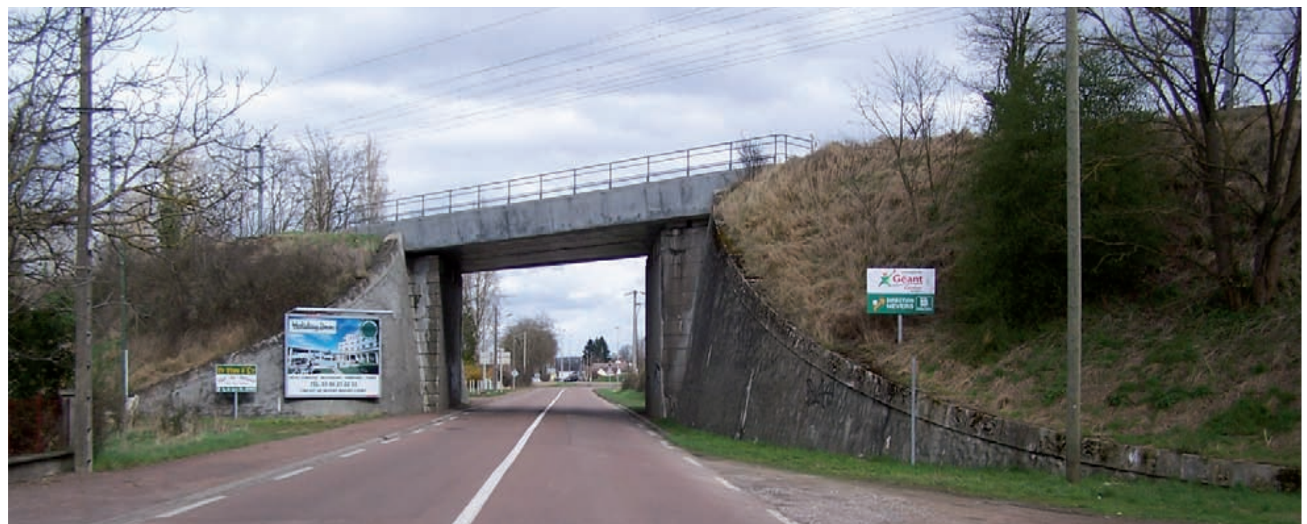
Cinq des dix ouvertures dans le remblais SNCF qu'il faudrait fermer pour éviter le remous
